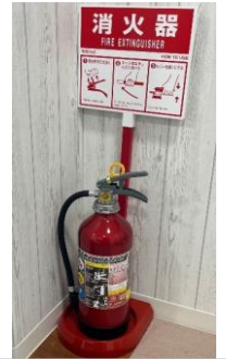
消火器をフロアに設置
